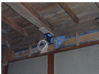
木造住宅の天井裏設置事例
