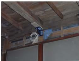
木造住宅の天井裏設置事例
